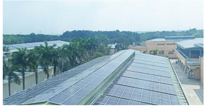
Hệ thống điện mặt trời áp mái, công suất 3MWh
